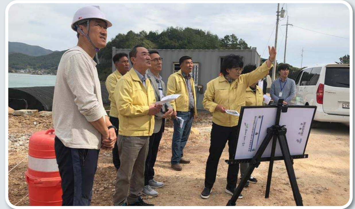
2018~2019년도 군발주사업 행정사무조사 (2019. 10. 23.) 포두 오취 급경사지 붕괴 위험지구 정비사업 현장 조사
